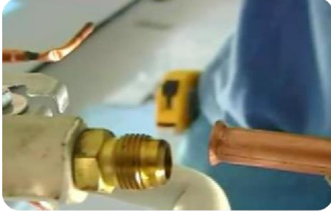
Dış ünite ve iç ünitelere rakorlu bağlantı
